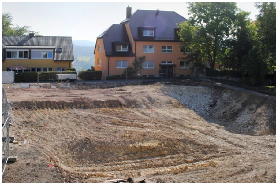
Jetzt ist da ein großes Loch, wo dieses erste Rettungshaus stand
