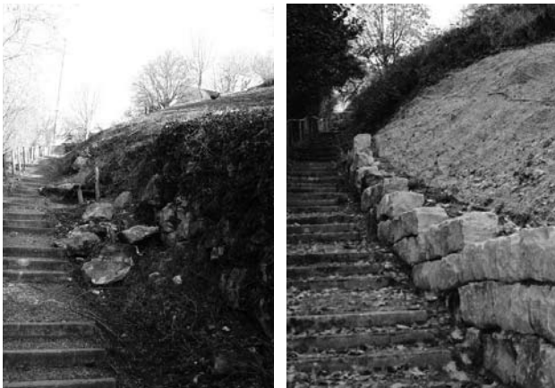
Nach den starken Winterfrösten geriet die Steinmauer in Bewegung. Der Westweg musste unterhalb der Tüllinger Kirche gesperrt werden (links). Der neu befestigte Aufstieg von Alt-Weil nach Ober-tüllingen (rechts).
